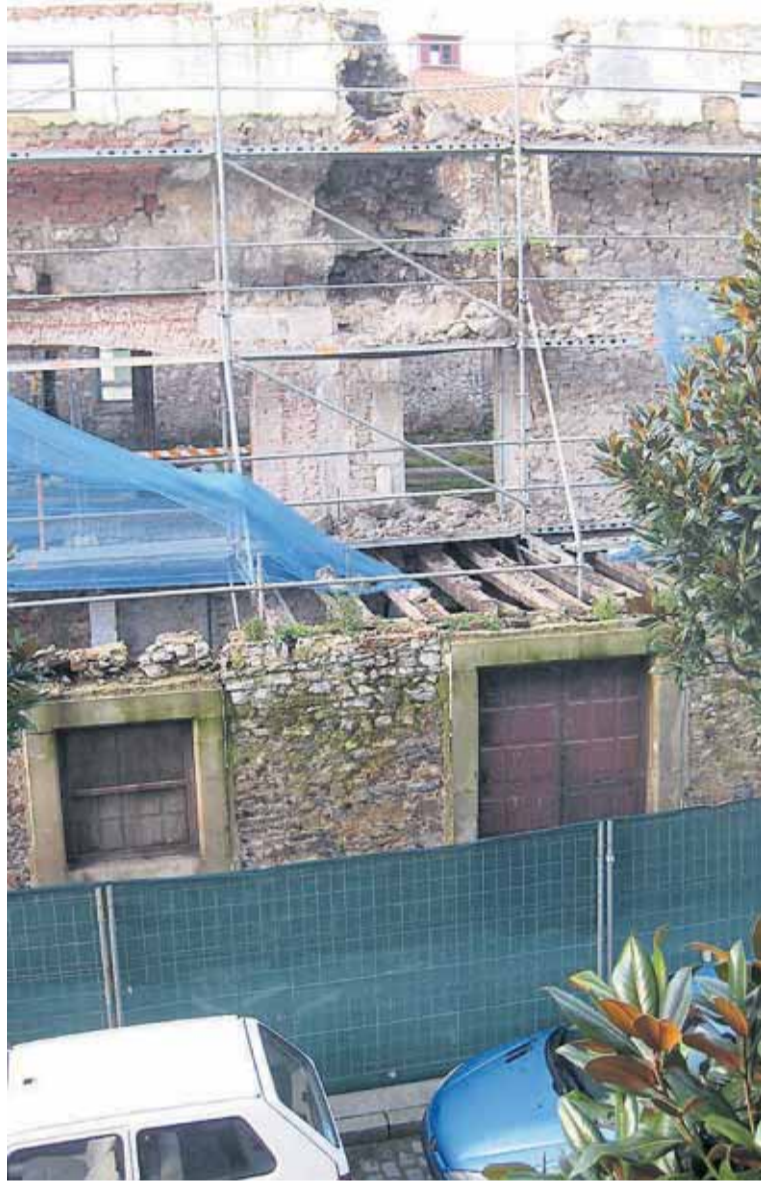
Aspecto del muro desplomado en la Casa de los Hevia. :: T. BASTERRA
